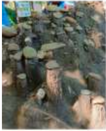
石柱受到風化侵蝕
